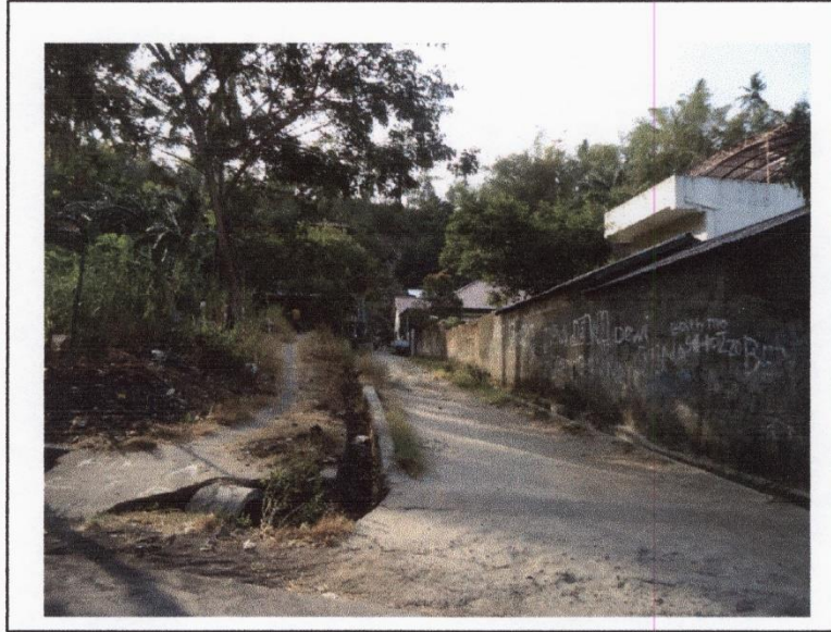
Gambar 10. Kondisi Saluran Pasangan Batu yang Rusak
