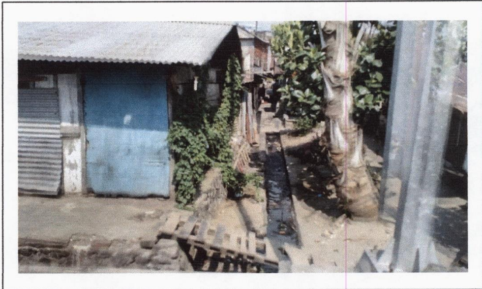
Gambar 6. Kondisi drainase yang tidak dapat mengalir
