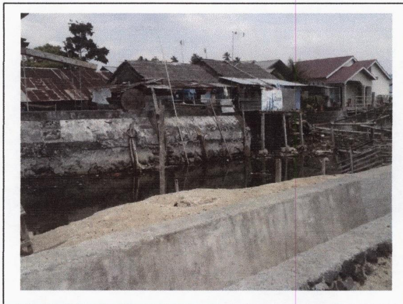
Gambar 11. Sistem Pengolahan Air Limbah Setempat yang Tidak Sesuai Standar
