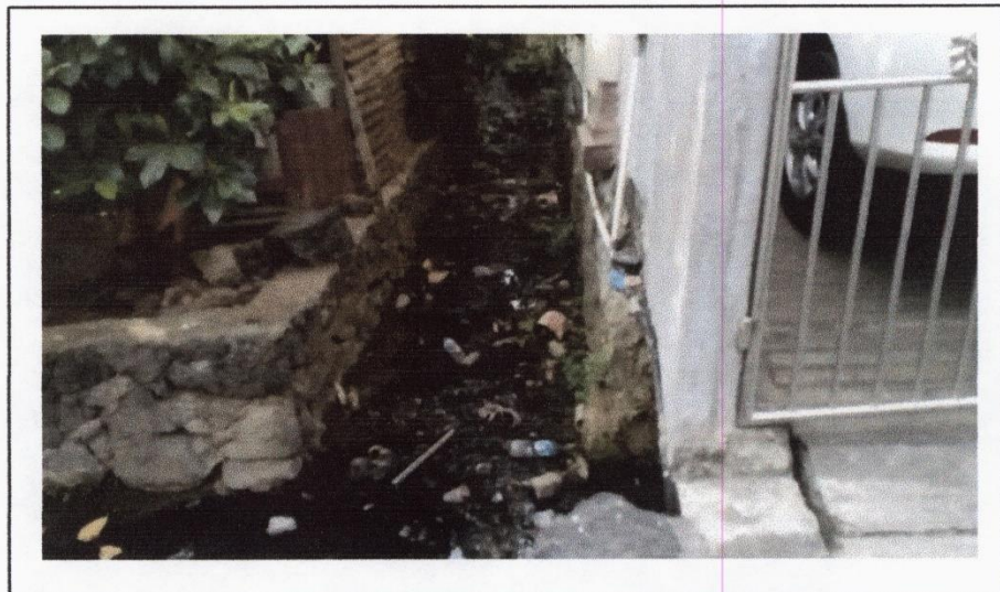
Gambar 9. Kondisi Saluran Drainase yang Tidak Terpelihara
